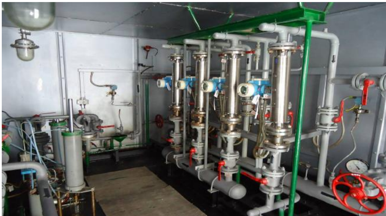
Рисунок 1 – Общий вид СИКН
