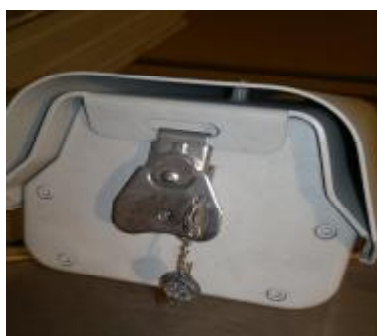
Рис. 2. Пломбирование блоков управления
