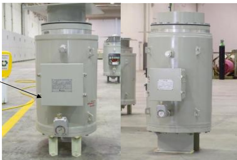
Рисунок 1- Общий вид трансформаторов напряжения SVR-10, SVR-20
