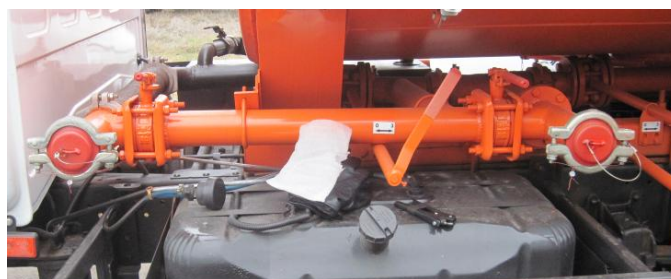
Всасывающий и нагнетающий трубопроводы
