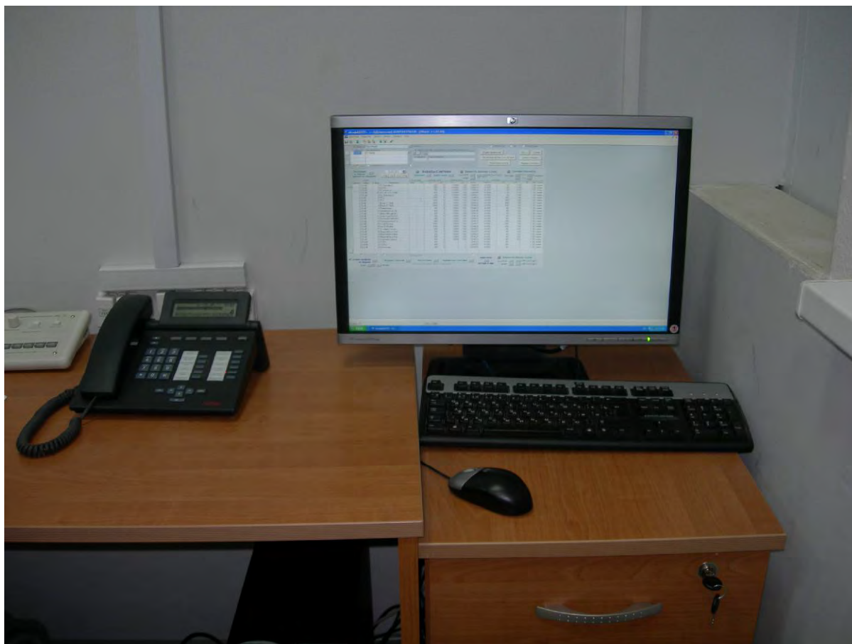
Общий вид основных составных частей АИИС КУКЭ ПС 110 кВ «Лаура»
