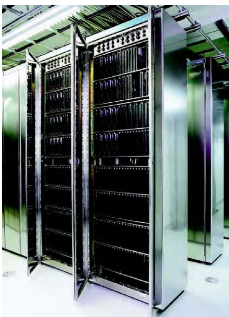
Рисунок 1 Общий вид оборудования с открытой дверью
