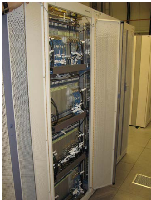
Рисунок 1 - Общий вид оборудования с открытой дверью
