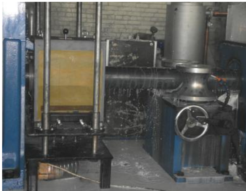
Рисунок 4 – Внешний вид блока преобразователей на трубном стане.
