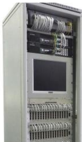
Рисунок 1 Общий вид оборудования с открытой дверью
